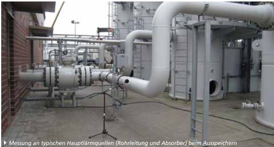
► Messung an typischen Hauptlärmquellen (Rohrleitung und Absorber) beim Ausspeichern
