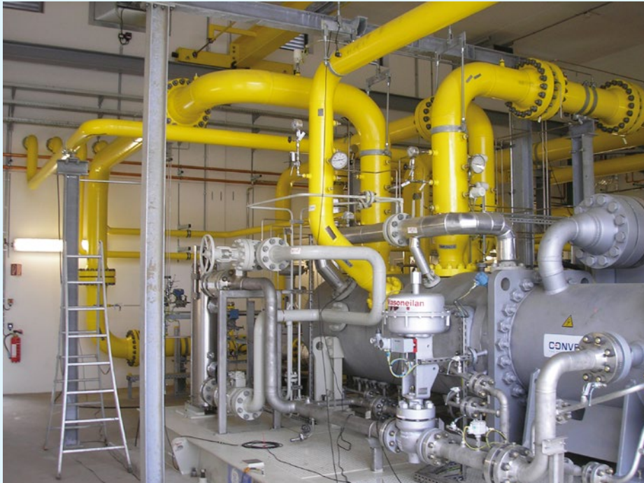
Magnetgelagerte Turboverdichteranlage mit angeschlossenem Rohrleitungssystem
