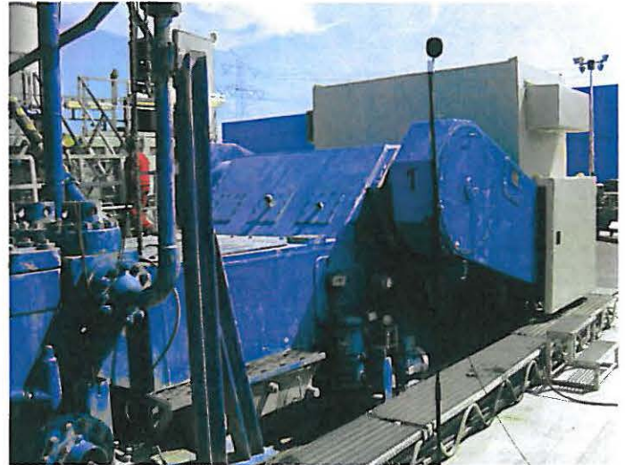
Bild 1: Spülpumpenaggregat mit eingehauster Antriebsmotoreinheit
