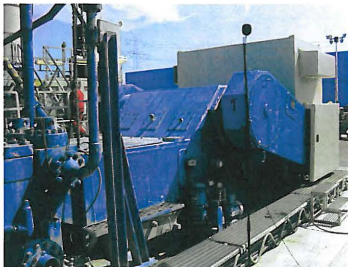
Bild 1: Spülpumpenaggregat mit eingehauster Antriebsmotoreinheit
