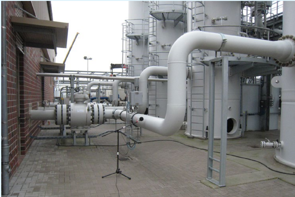
Messung an typischen Hauptlärmquellen (Rohrleitung und Absorber) beim Ausspeichern
