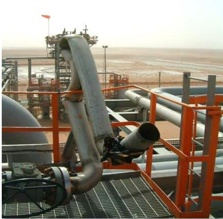
Abbildung 9: Akustischer Ermüdungsbruch durch sehr hohe Schallleistungspegel in der Rohrleitung, kritisch: L_w > 155 \text{ dB}
